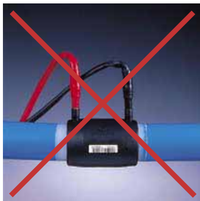
Рис. 63 Вставленные не до конца трубопроводы сваривать нельзя
