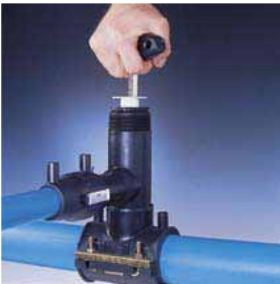
Рис. 48 9. После завершения гидравлического испытания торцовым ключом на 12 завернуть фрезу в тело трубы
